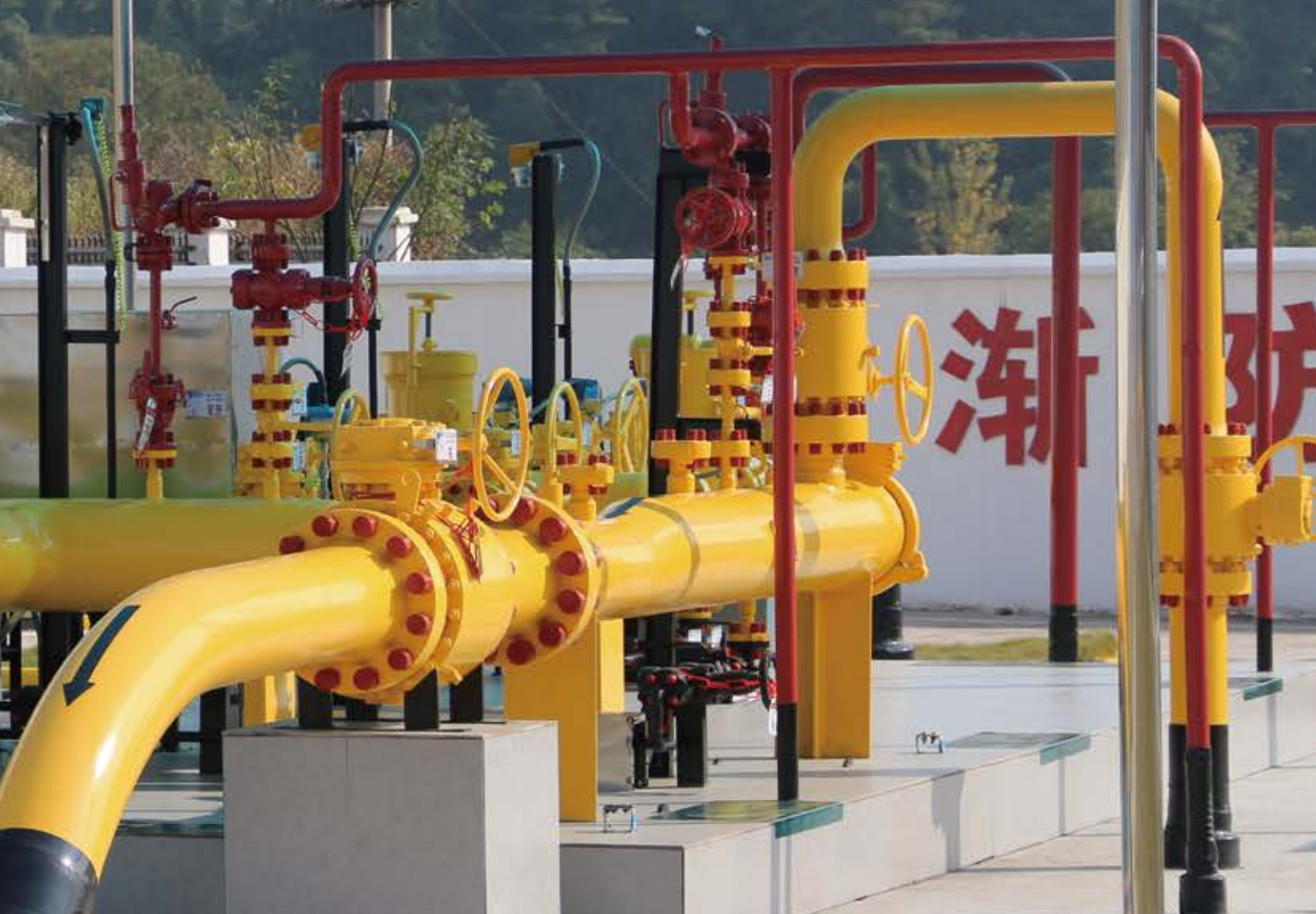
位於江西的萍鄉港華新棚門站規範整潔，為安全平穩供氣提供保障
